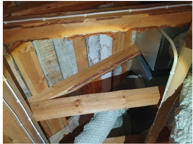
Läpiviennin alapuolella vuotojälki
