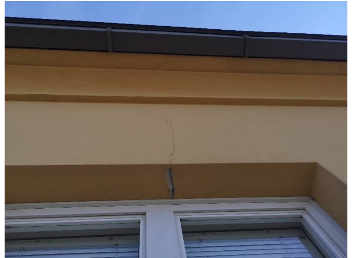
Halkeama ja rappaus ikkuna-aukon kohdalla
