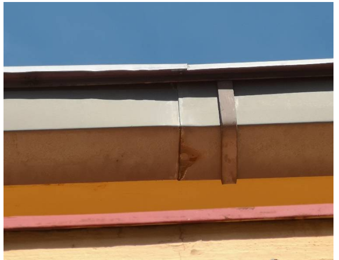
Etulapteen kourussa vuotojäljet sauman kohdalla
