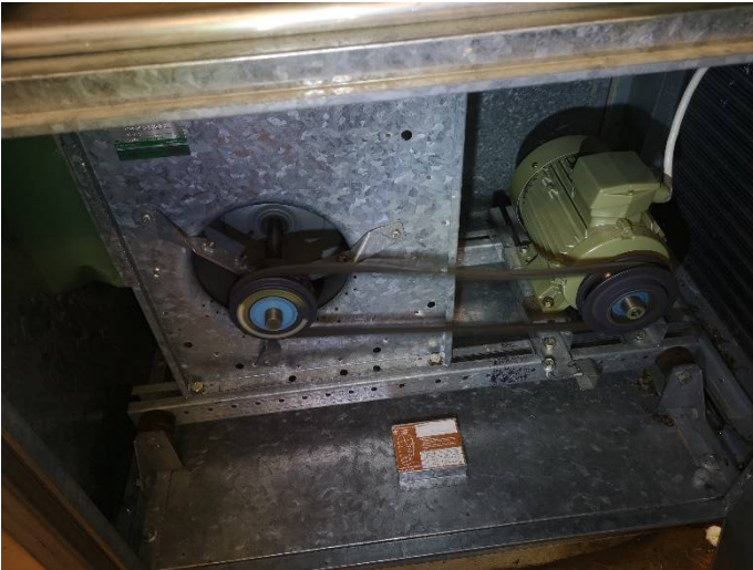
Tuloilmakoneen puhaltimen hihna löysällä
