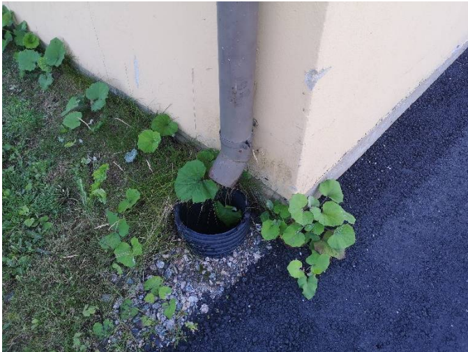
Kattosadevedet johdettu rumpuputkesta tehtyyn sadevesikaivoon
