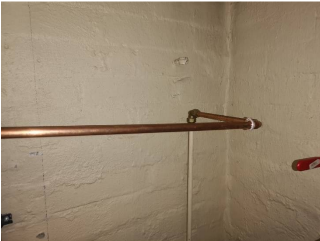
Kupariputki kannakoimatta kattilahuoneessa
