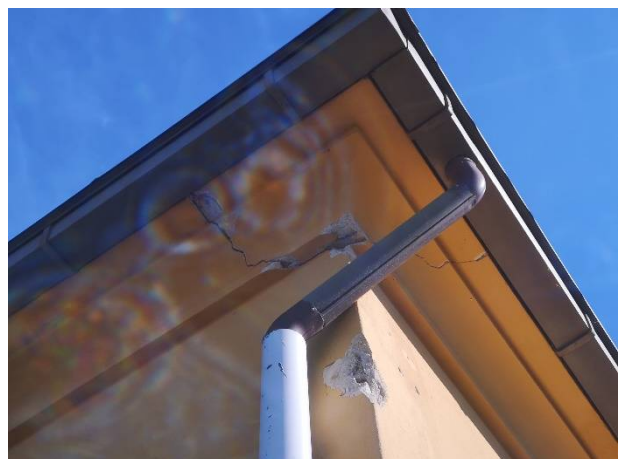
Halkeama räystäään alla
