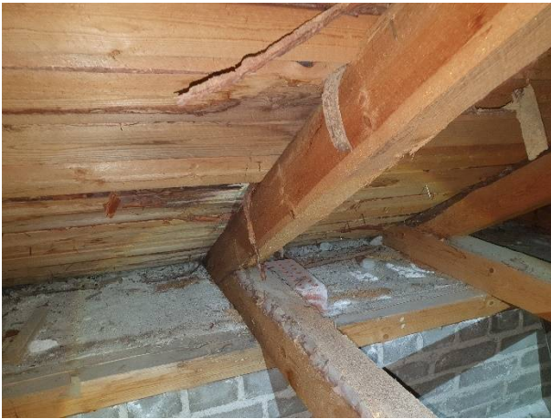
Vanhoja vuotojälkiä puurakenteissa
