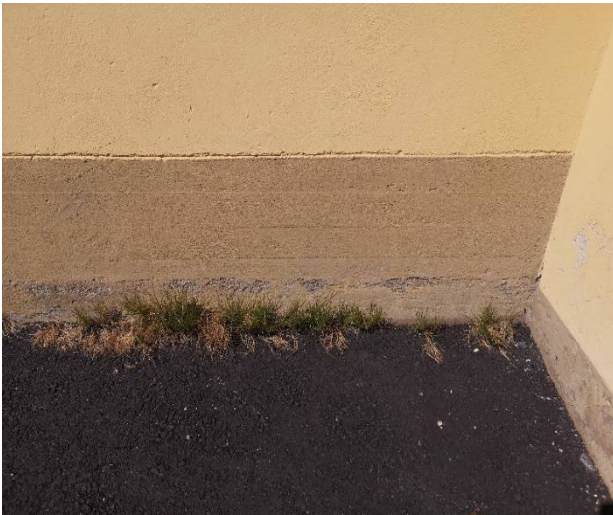
Sokkelipalkin alaosassa rapautumaa/maalipinnan hilseilyä
