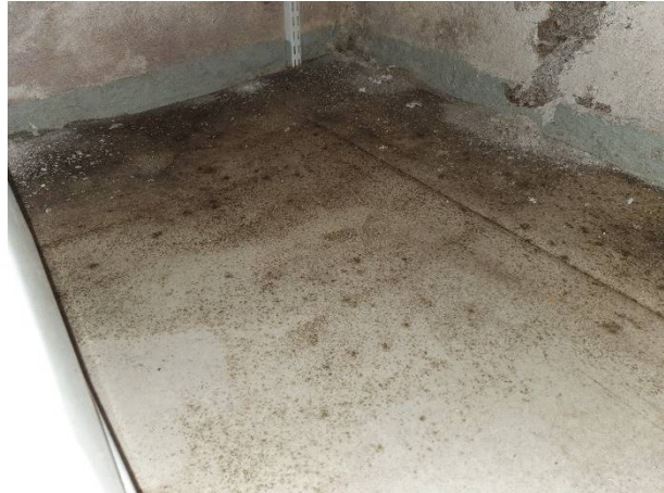
Muovimatto vaurioitunut kosteudesta
