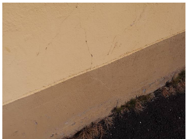
Elämiseen/liikkumiseen viittaava halkeama sokkelissa ja ulkoseinässä
