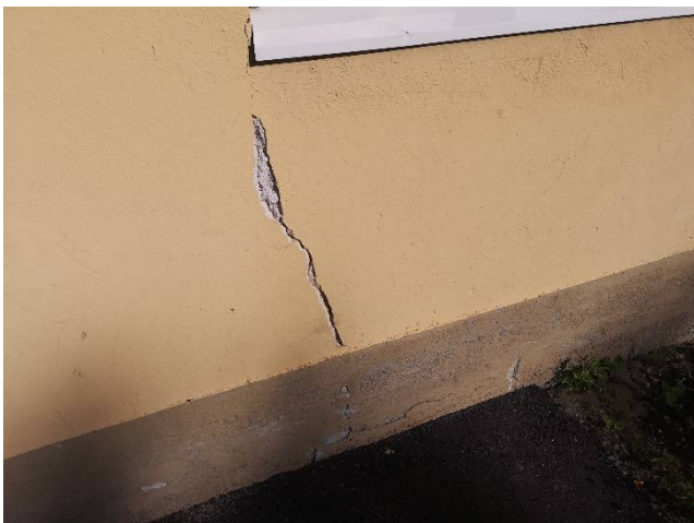
Perustusten elämiseen/liikkumiseen viittaavia halkeamia sokkelissa ja ulkoseinässä
