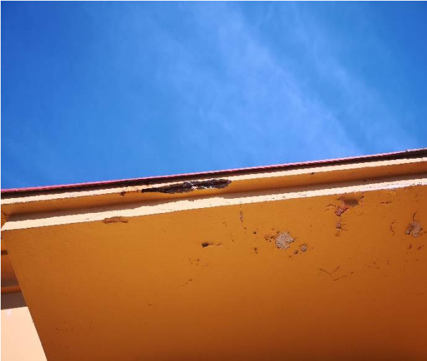
Sisääntulokatoksessa rapautumaa, harjateräs esillä
