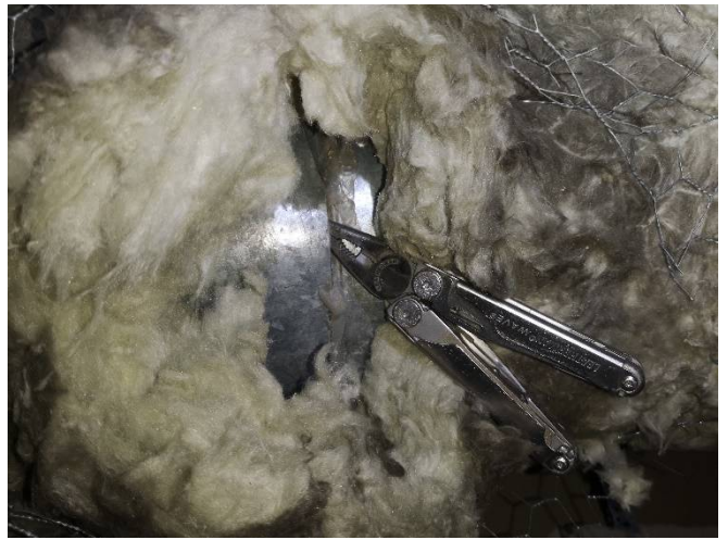
Kanavan sauma ei ole tiivis ilmavuotojäljen kohdalla
