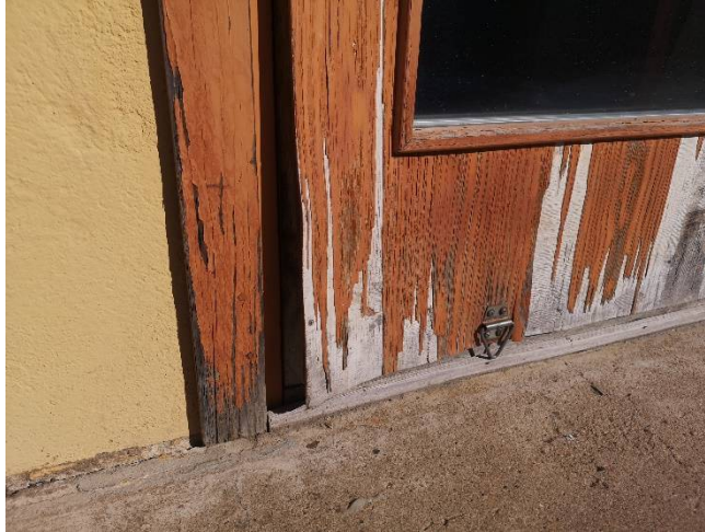
Ulko-oven vaneripinta ravistunut ja irronnut
