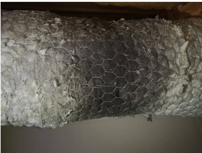
Kanavaeristeessä ilmavuotojälki IV-konehuoneen vieressä
