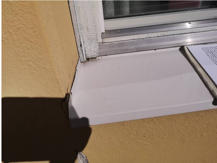
Ikkunan vesipellin nurkka ei täysin tiivis
